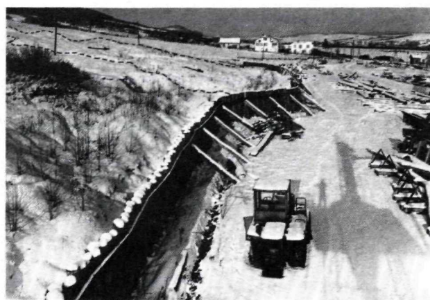
Obr. 9. Pohľad na deformovanú časť provizórnej opornej steny v čelnej časti prúdového zosuvu. V popredí steny je stavenisko skládky dreva. Stav 16. 12. 1988.
